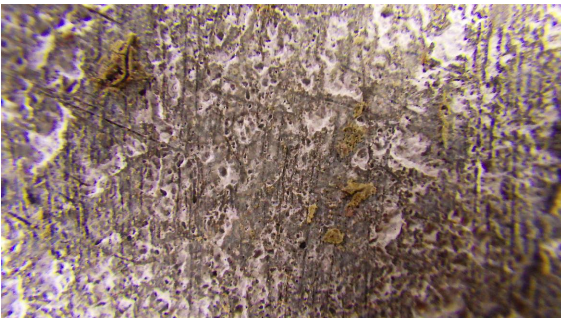
Lotr - detail, na zkorodovaném povrchu stopy suříkového základu a povrchové úpravy imitující bronz. Cca 5 stejných nátěrů
