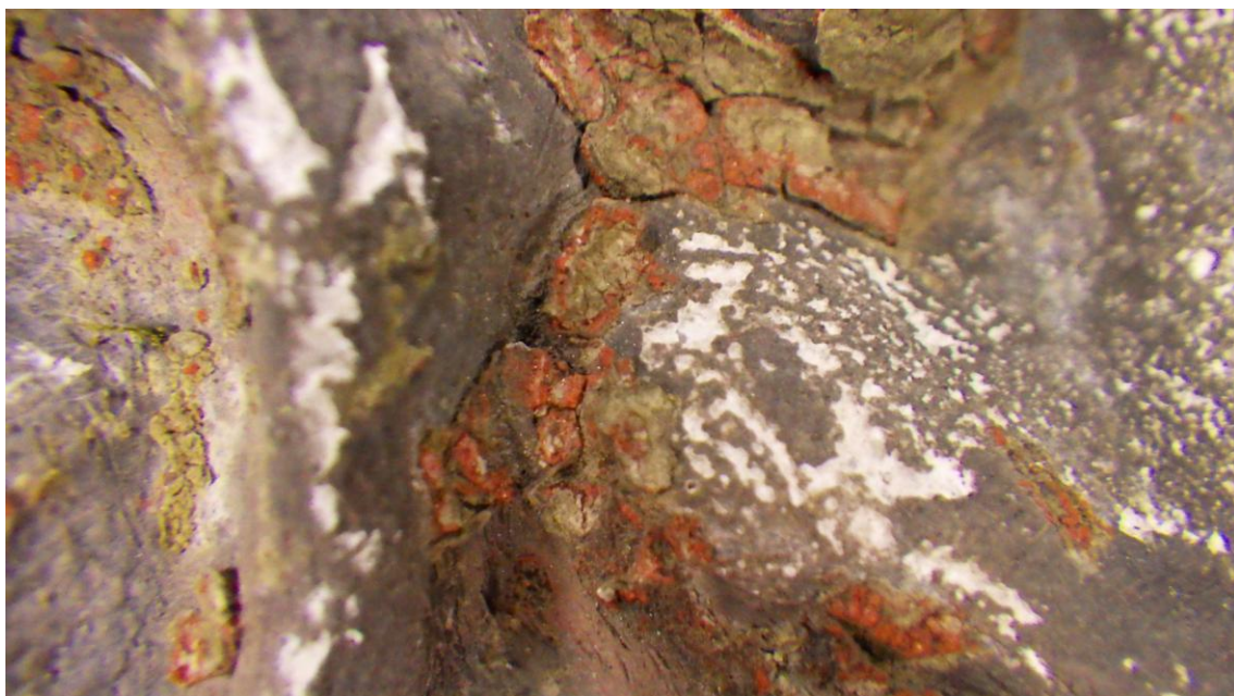
Lotr - detail, na zkorodovaném povrchu stopy suříkového základu a povrchové úpravy imitující bronz. Cca 5 stejných nátěrů
